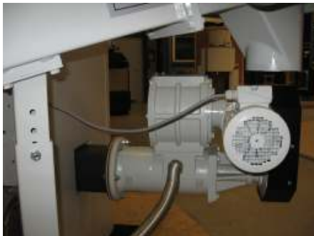
Zellenradschleuse mit Wasserlöscheinrichtung (HDG Bavaria)
