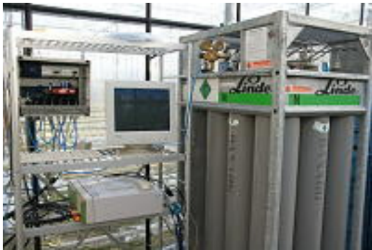
Foto 2: Regel- und Verteilstation mit Datenerfassung sowie ein 12 x 50 l BANARG ® -Bündel der Fa. Linde Gas
